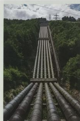
Bild 1: Walchenseekraftwerk, Bayern, 124 MW
